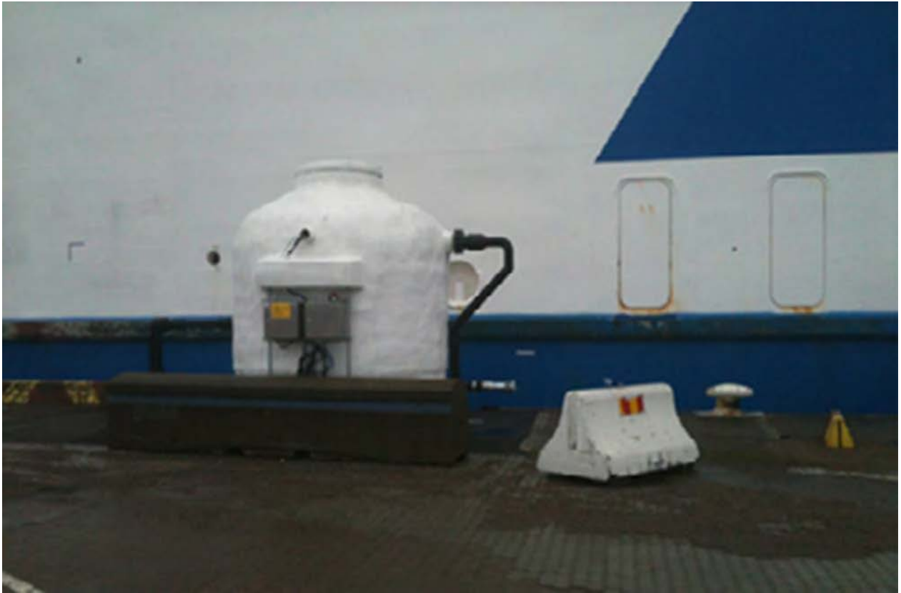
الشكل 9 : جمع مياه المجاري في ميناء Trelleborg ، السويد (حقوق الصورة : Clean Baltic Sea Shipping)
